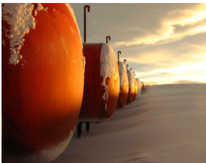
Imagen 1. Tanques de almacenamiento de gasoil en la base Argentina Marambio expuestos a condiciones ambientales invernales.
